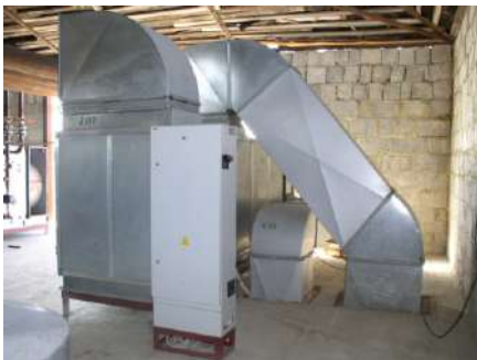
Щит для управления климатической установкой в процессе выращивания шампиньонов
