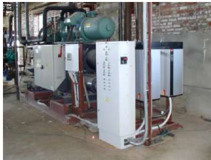
Щит силовой для управления тепловым насосом
