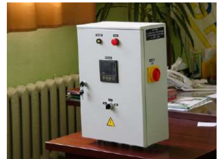
Щит управления системой вентиляции и кондиционирования
